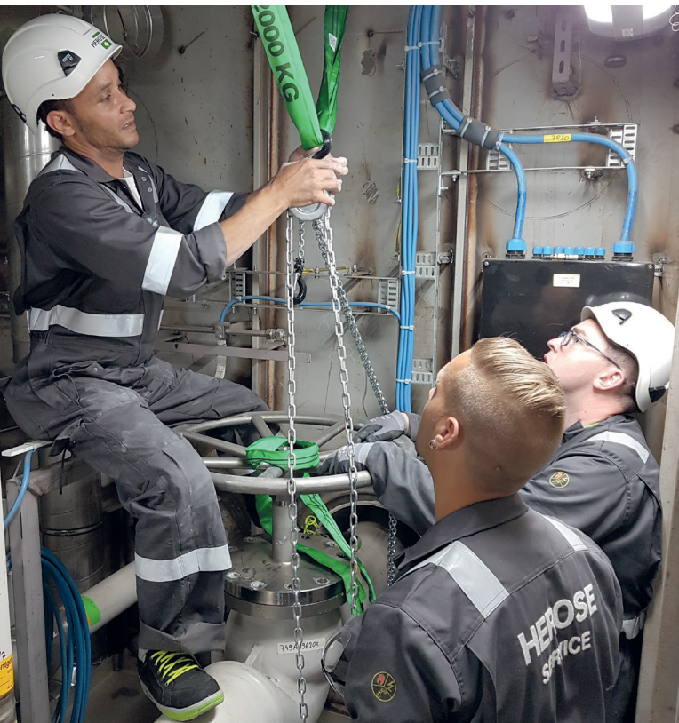
Die Spezialisten von HEROSE beim Service-Einsatz – ein mobiler Kettenzug hilft beim Handling der großen Ventile.
